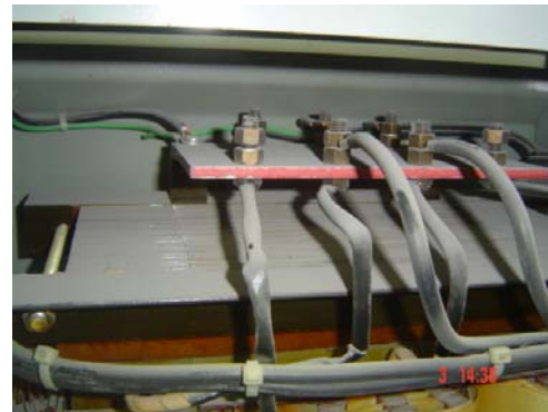
Transformador 5 de 10 Kva para UPS
