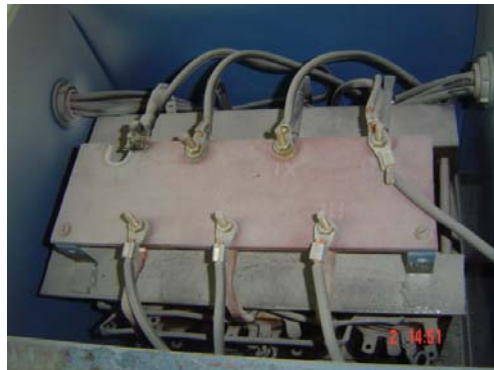
Transformador 2 de 45 Kva
