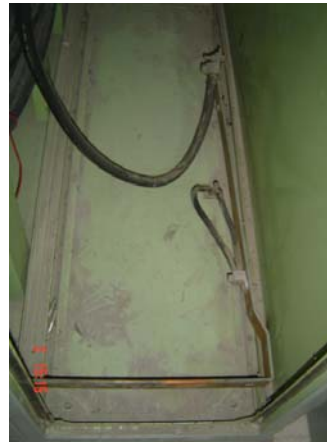
Barra de tierras de Tablero Principal
